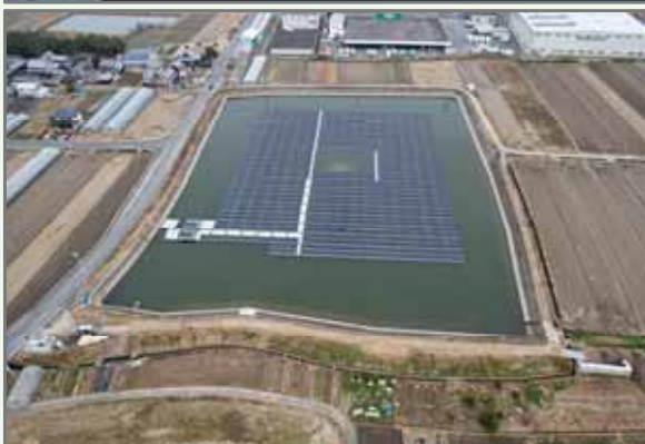
▲水上太陽光発電設備の設置状況
