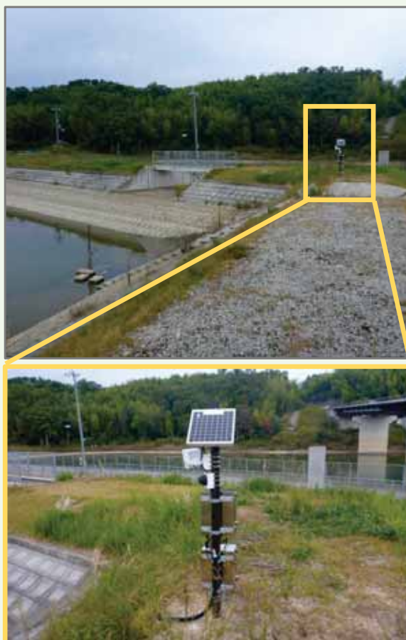
▲ ICT機器（水位計、カメラ）の設置状況
