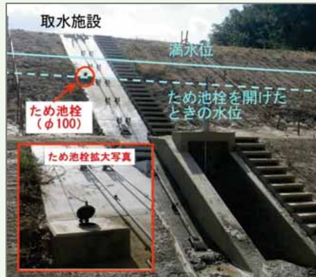
▲ため池栓の整備状況
